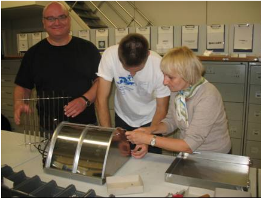
Abb. 2 Montage der Dekontaminationsanlage: Rechts ist der Boden, in der Mitte das Gehäuse mit Spiegel (K. Müller, Dr. Lugova) und links das Gitter zur Vermischung des bestrahlten Regenwassers (Dr. Götz) zu sehen.
